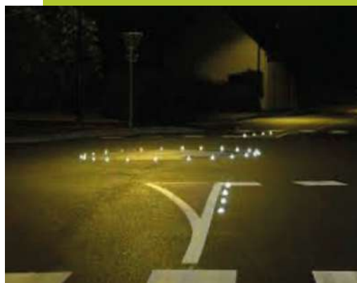
Figure 11 : Exemple de système d'éclairage passif (Source : F. Lamiot).
