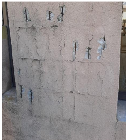
Etat du mur extérieur
