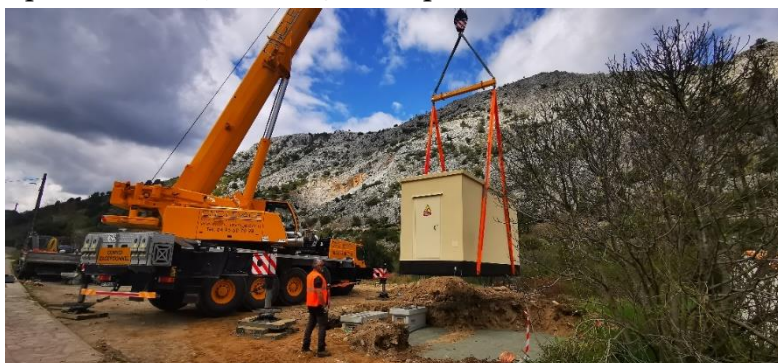
Installation d'un NRO 5noeud de raccordement abonné) à Capuralinu
