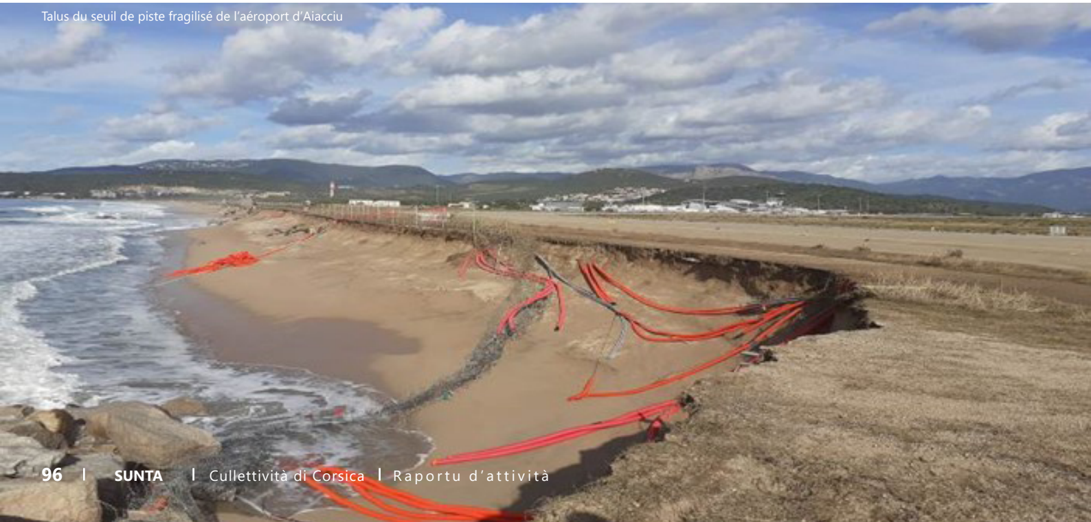
Talus du seuil de piste fragilisé de l'aéroport d'Ajaccio
