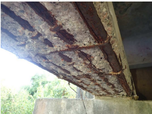
Rupture de cadres sur P1 et aciers oxydés – vue de dessous
