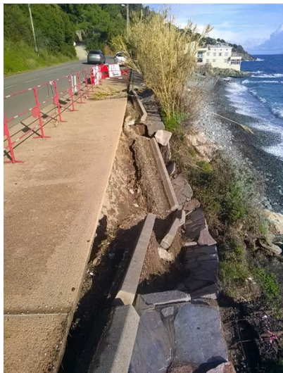
Désordres en partie Sud - 2019
