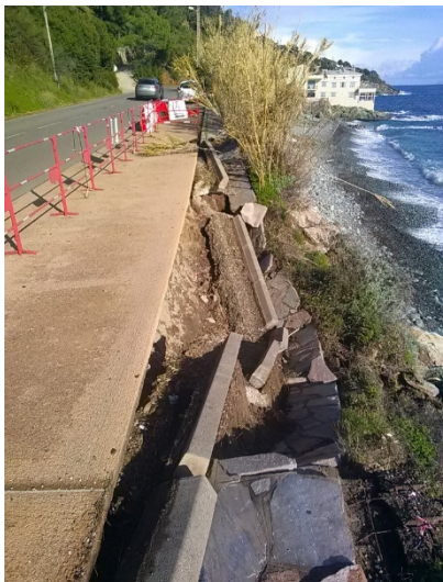
Désordres en partie Sud - 2019
