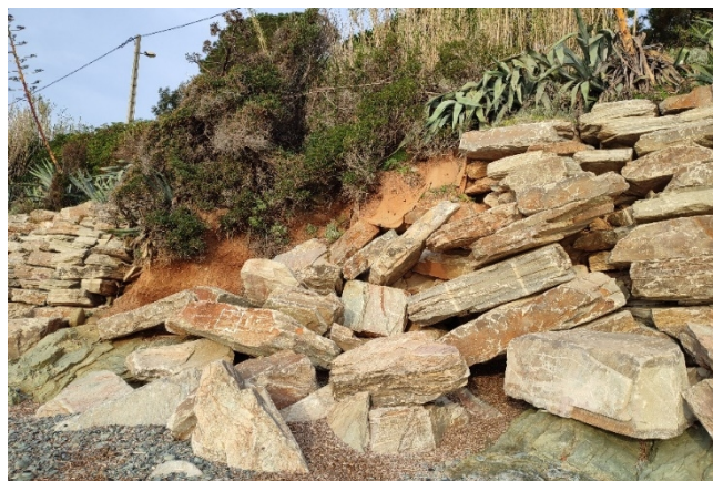
Désordre en partie Nord et substratum rocheux affleurant
