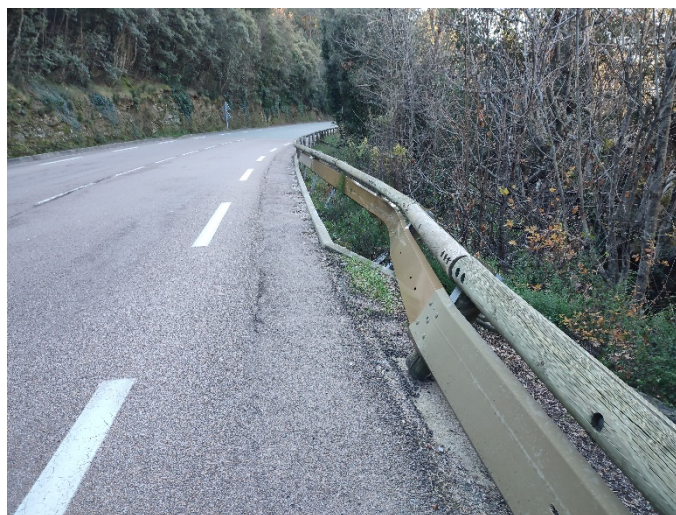
Chocs sur les glissières de sécurité
