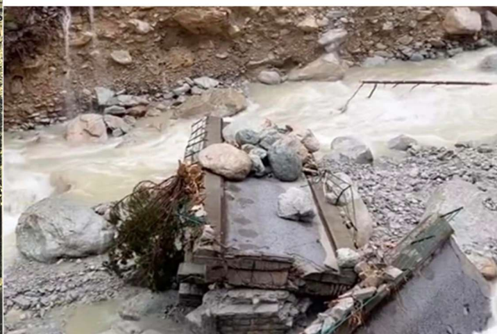
Pont de Tragone (post tempête)
