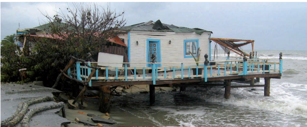
Restaurant de plage exposé à l'érosion côtière à Aléria en 2007
